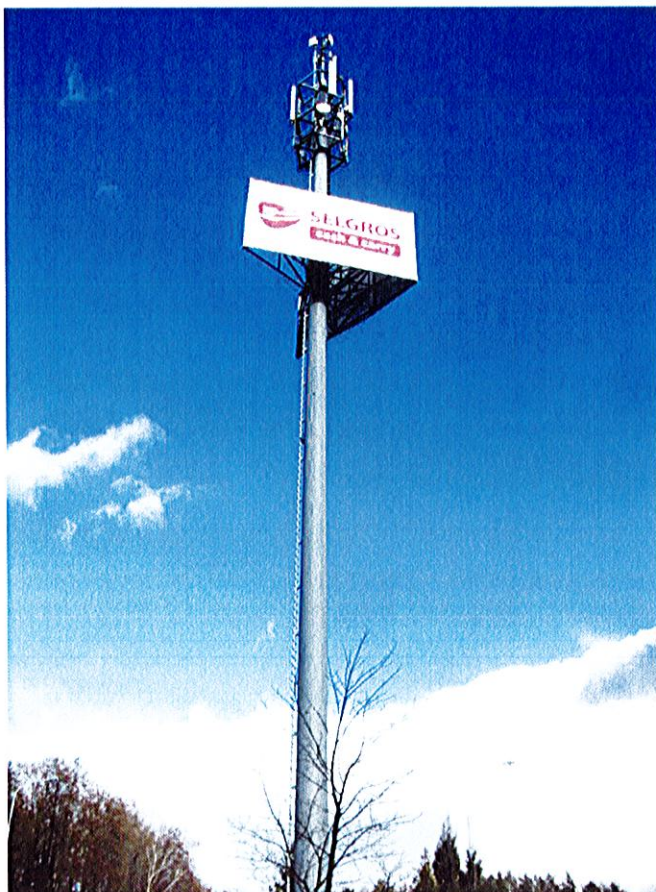
Zał. nr 1: Widok ogólny instalacji radiokomunikacyjnej.
