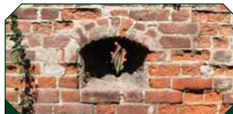
W murze obronnym w Jaskotlu przez pomyłkę odwrotnie umieszczono otwory strzelnicze, rozszerzają się bowiem na zewnątrz muru.
